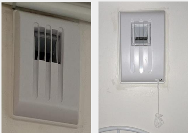
Les bouches d'extraction
